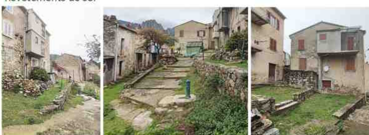
Sol en terre et revêtements béton non entretenus de l'espace public à Ghisoni
