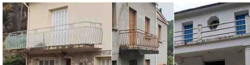
Garde-corps en ferronneries ou composés de tubes circulaires épais Ces photographies montrent aussi la diversité des ouvertures et de leurs formes
