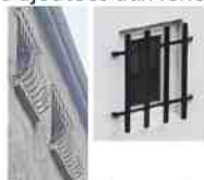
Grilles de défense posées sur quelques fenêtres de maisons (E Case)
